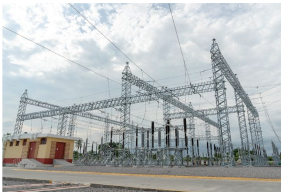
Subestación PET Santa Isabel 230/69 KV
