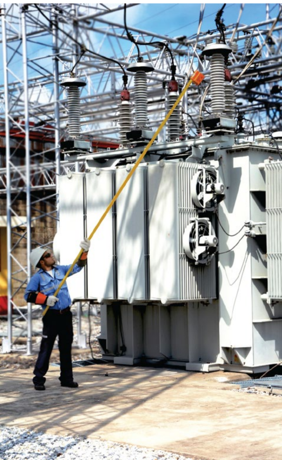
Infraestructura física TRELEC
